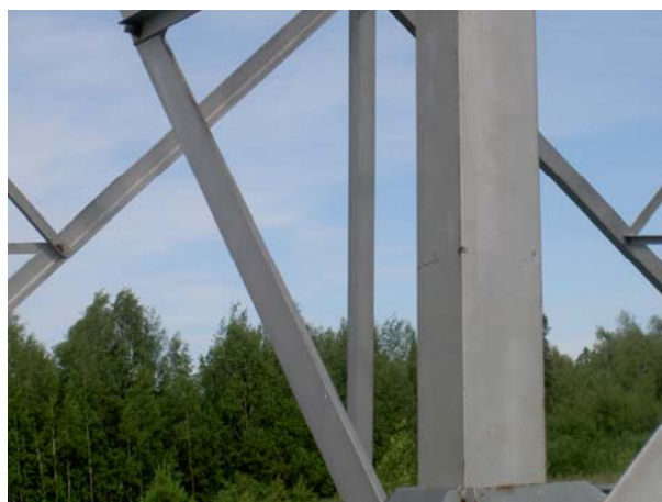
Рис. 3. Общий вид опор ВЛ 500 кВ Ишим . Тобольск (после 5 лет эксплуатации) с заводским покрытием, полученным методом «холодного» цинкования по схеме Цинол + Алпол
